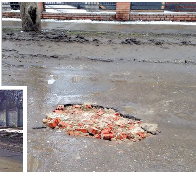
Дороги, перекрытые ГИБДД, дорожники «чинят» кирпичом
